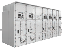
Metal Clad Switchgear
