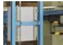
Coffret Atlantic fixé sur poteau horizontal avec réf. 0 364 48
