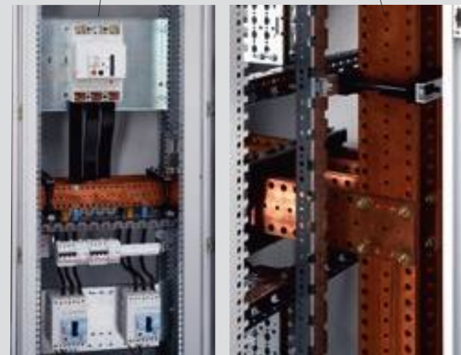
Montage d'un DPX 3 1600 A et d'un DPX 250 A (vue intérieure d'armoire, plastrons ôtés)
