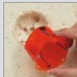
Pénétration limitée des matériaux de scellement
