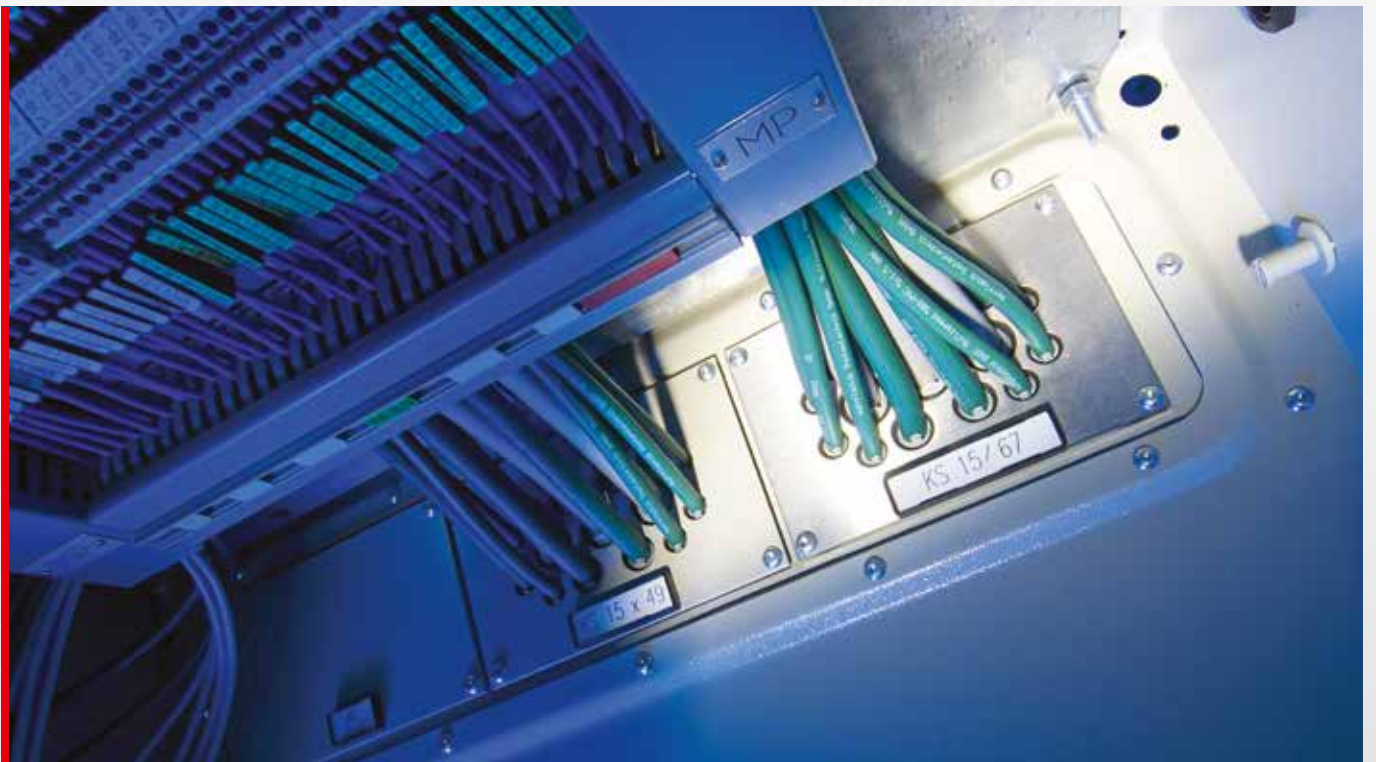
KDP 105/15 dans l'armoire de commande
