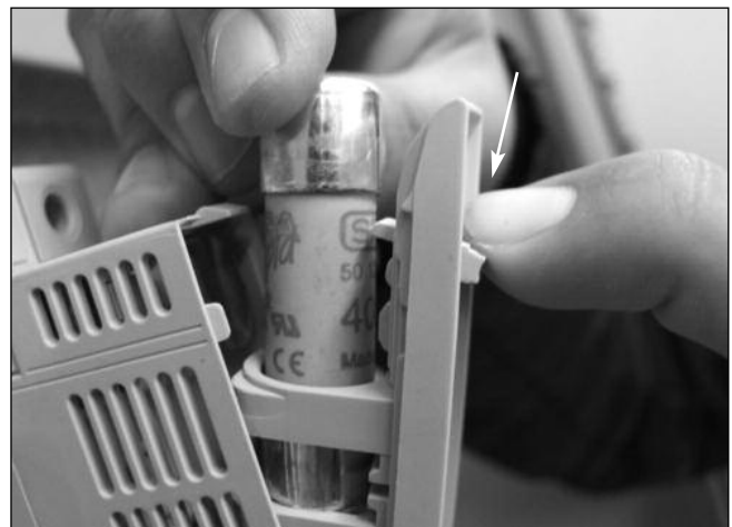
4. Halteclip der Sicherung herunterdrücken, um die Sicherung zu entnehmen oder einzusetzen.
