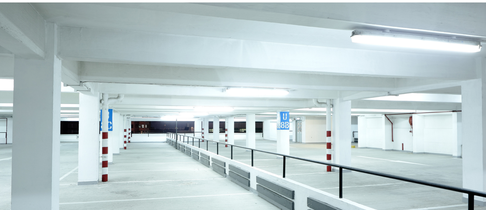
Lampade per ambienti umidi – Interiore – Parcheggio sotterraneo con AL60
