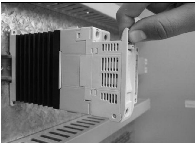
1. Preparación para abrir el portafusibles.
